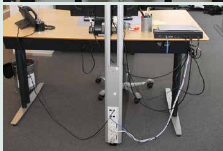
Ledninger samles i kabel-kanaler.
